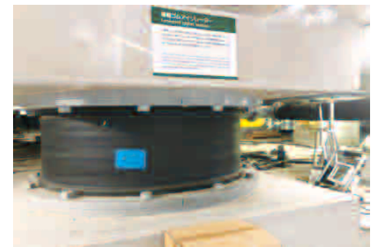
写真2 免震ギャラリーの積層ゴム
