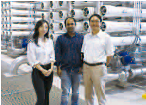
写真4 H2Oaks Centerの逆浸透膜処理装置
